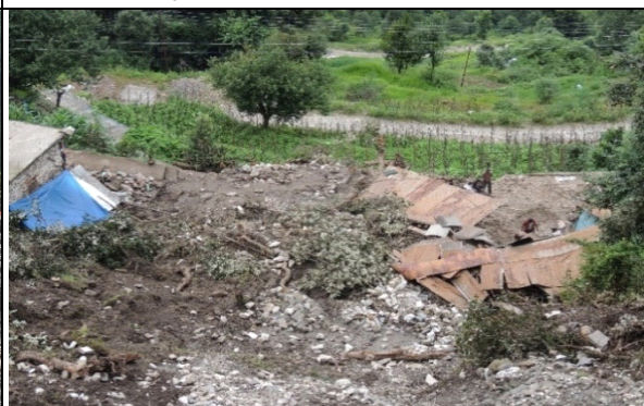
चित्र-7: तहसील बंगापानी के अन्तर्गत ग्राम गैला में भूस्खलन से क्षतिग्रस्त भवनों की स्थिति
